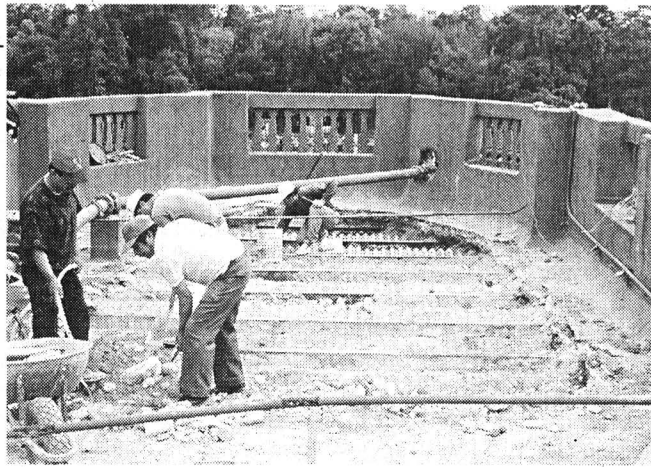
Trabajos de liberación de la impermeabilización no original, enladrillado, entortado y terrado de la cubierta de azotea del salón sur.
