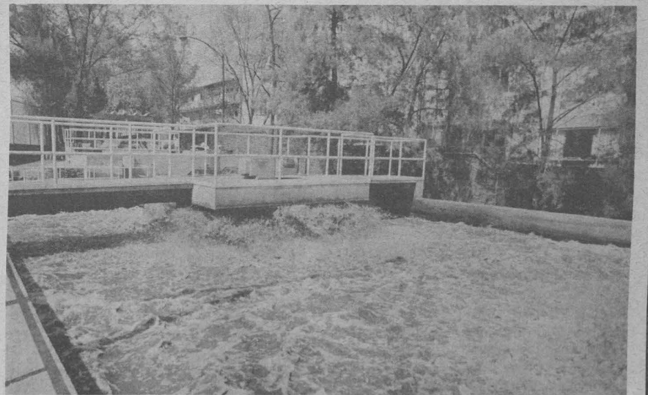
Otra de las obras construidas es la planta de tratamiento de aguas residuales, la cual se destina al riego de áreas jardinadas; se evitará, así, el consumo de agua potable para este fin.
