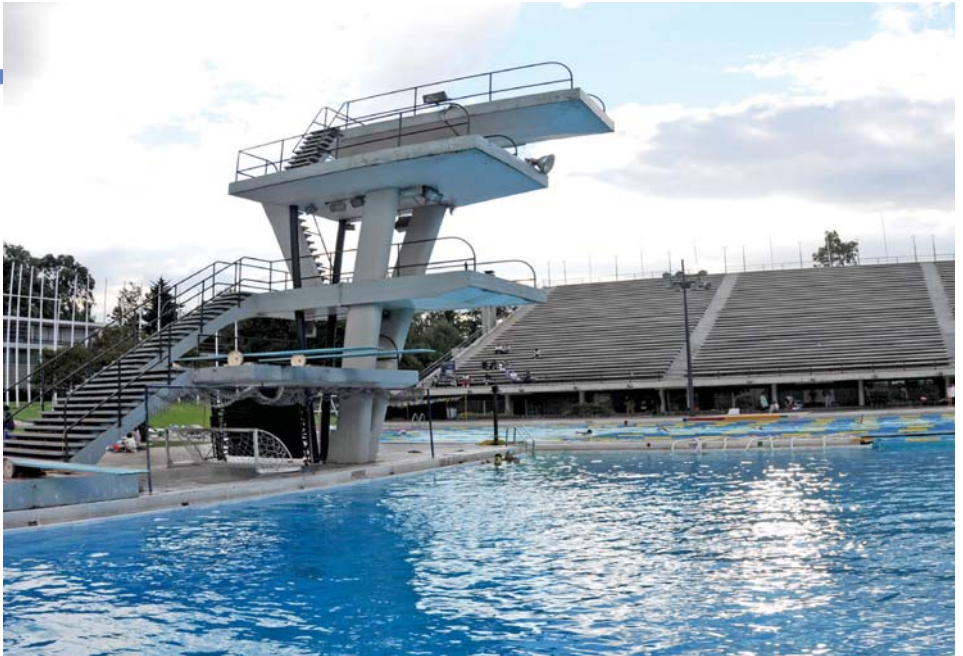
En marcha, sistema solar para el calentamiento de la Alberca Olímpica de Ciudad Universitaria. Fotos: Juan Antonio López y cortesía EcoPuma.
