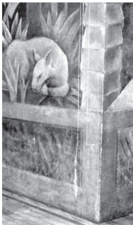
Golpes y manchas de escurrimiento.
